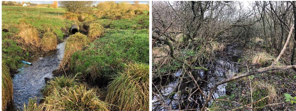
Figur 14: Eksempel på den lysåbne strækning med forekomst af grus på bunden (t.v.) og kratområdet med blød sandet bund (t.h.) Rørbroen på billedet til venstre er en af de to observerede rørbroer, som har for højt fald og dermed udgør en faunaspærring.
